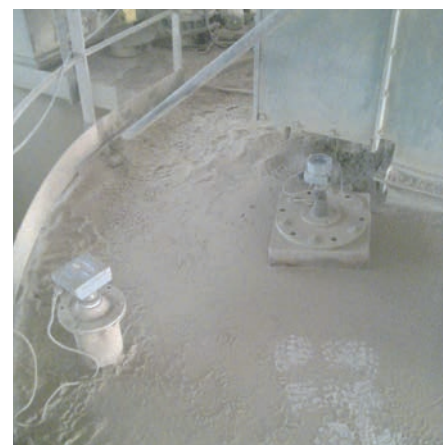
MESURE DE NIVEAU DANS DES SILOS
